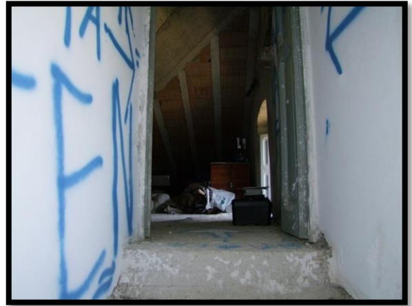
F. 28: ACCESSO ALLA SOFFITTA UBICATA AL PIANO 2° SOTTOTETTO IN CONTRADA MARCIANESE, N. 140, LANCIANO (CH), P.LLA 4195 SUB. 2 (A/4)
