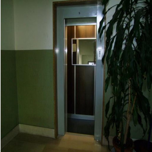
FOTO 17: ASCENSORE COMUNE AL FABBRICATO PLURIFAMILIARE POSTO AL PIANO 5° DI VIA ANDREA MANTEGNA, N. 2, ISERNIA (IS), P.LLA 372
