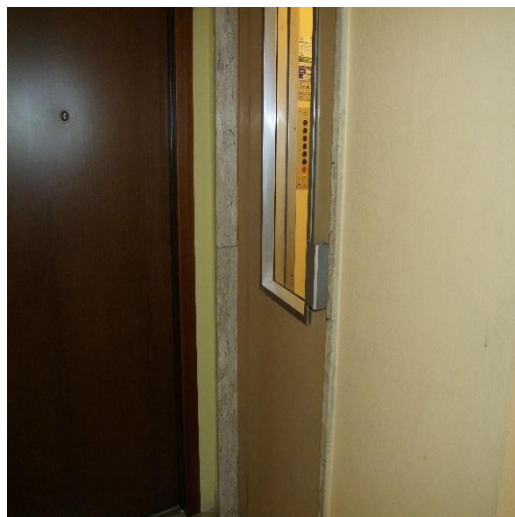
FOTO 38: ASCENSORE COMUNE UBICATO AL PIANO 4°, P.LLA 1093
