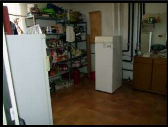
F. 15: INTERNO DELLA CENTRALE TERMICA UBICATO AL PIANO TERRA IN VIA CIPRANENSE, N. 38 – BUSSO (CB), P.LLA 504 SUB. 5 (C/6)
