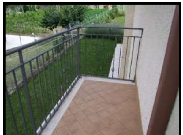
F. 30: BALCONE DELL'ABITAZIONE UBICATO AL PIANO 1° IN VIA CIPRANENSE, N. 38 – BUSSO (CB), P.LLA 504 SUB. 6 (A/3)
