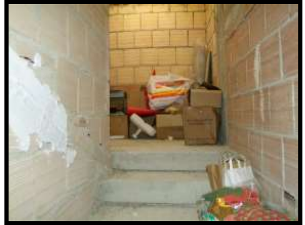
F. 44: ACCESSO ALLA SOFFITTA UBICATA AL PIANO 3° SOTTOTETTO IN VIA CIPRANENSE, N. 38 – BUSO (CB), P.LLA 504 SUB. 6 (A/3)
