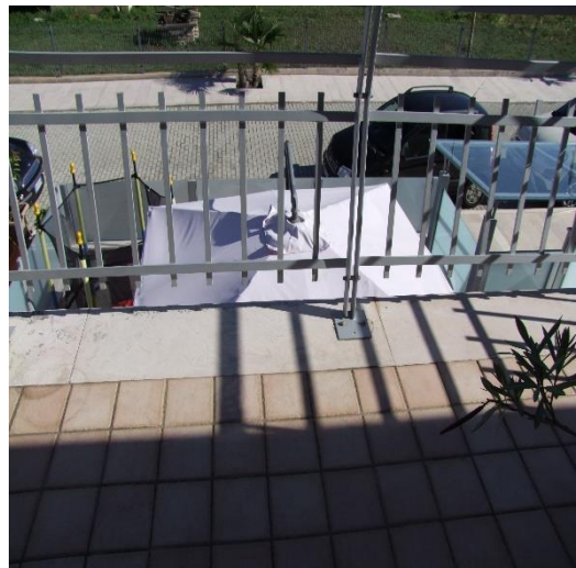
FOTO 36: BALCONE DEL RIPOSTIGLIO "2" POSTO AL PIANO 1°, P.LLA 4213 SUB. 7 (A/7)
