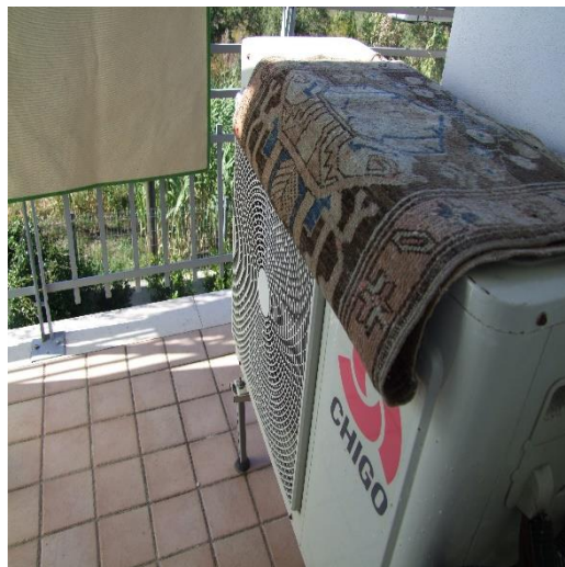
FOTO 26: BALCONE DEL W. C. POSTO AL PIANO 1°, P.LLA 4213 SUB. 7 (A/7)
