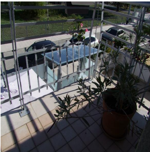
FOTO 35: BALCONE DEL RIPOSTIGLIO "2" POSTO AL PIANO 1°, P.LLA 4213 SUB. 7 (A/7)
