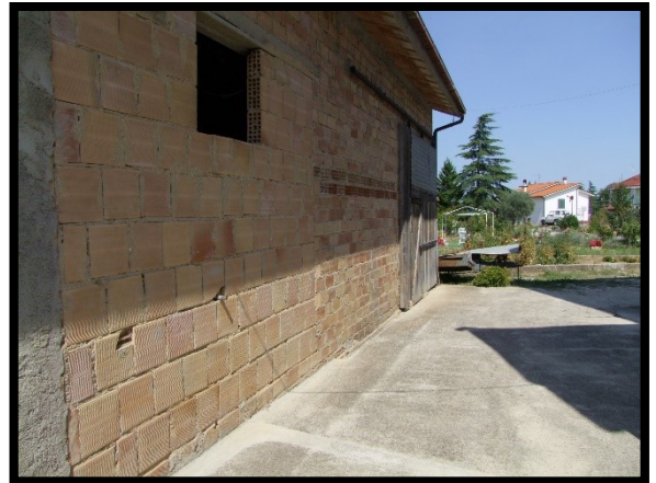
F. 34: ACCESSO AL DEPOSITO UBICATO AL PIANO TERRA IN VIA PIANA PELLEGRINA, N. 1 – ORSOGNA (CH), P.LLA 4220 SUB. 1 (B.C.N.C.)
