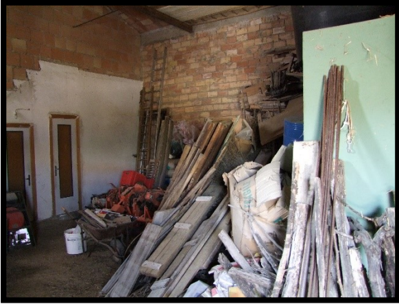
F. 37: INTERNO DEL DEPOSITO UBICATO AL PIANO TERRA IN VIA PIANA PELLEGRINA, N. 1 – ORSOGNA (CH), P.LLA 4220 SUB. 4 (C/2)
