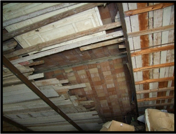
F. 39: INTERNO DEL DEPOSITO UBICATO AL PIANO TERRA IN VIA PIANA PELLEGRINA, N. 1 – ORSOGNA (CH), P.LLA 4220 SUB. 4 (C/2)
