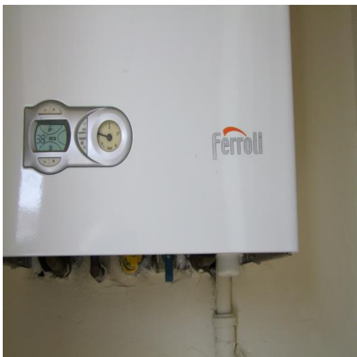
FOTO 41: CALDAIA DELL'IMPIANTO TERMICO AUTONOMO UBICATA SUL BALCONE, IN CONTRADA GAUDO, N. 37, BARANELLO (CB), P.LLA 524 SUB. 30 (A/3)
