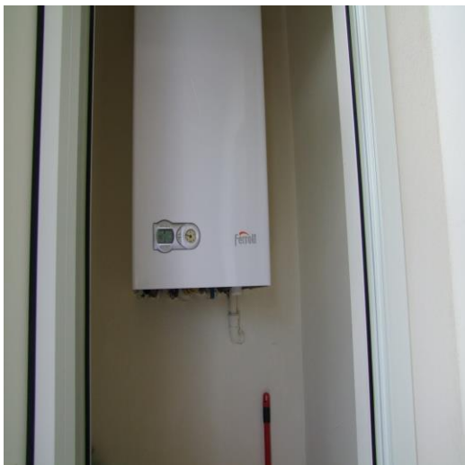
FOTO 39: CALDAIA DELL'IMPIANTO TERMICO AUTONOMO UBICATA SUL BALCONE, IN CONTRADA GAUDO, N. 37, BARANELLO (CB), P.LLA 524 SUB. 30 (A/3)
