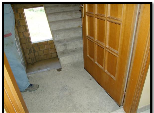
F. 24: ACCESSO ALLA SOFFITTA UBICATA AL PIANO 1° SOTTOTETTO IN CONTRADA CAMPOGRANDE, N. 45, TORINO DI SANGRO (CH), P.LLA 4070 SUB. 2 (A/2)
