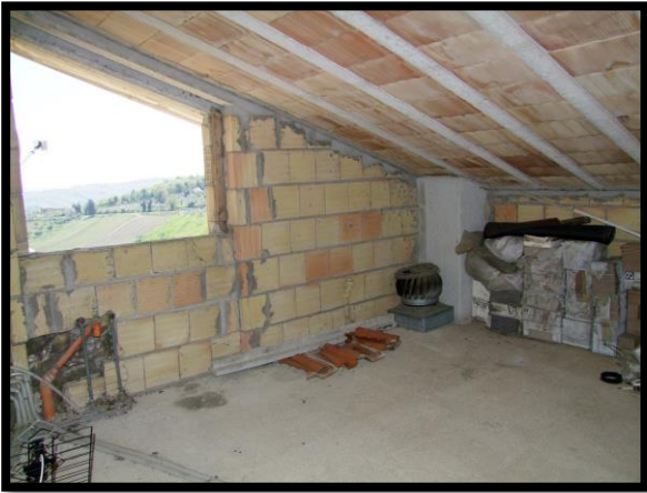
F. 33: INTERNO DELLA SOFFITTA UBICATA AL PIANO 1° SOTTOTETTO IN CONTRADA CAMPOGRANDE, N. 45, N. 45 – TORINO DI SANGRO (CH), P.LLA 4070 SUB. 2 (A/2)
