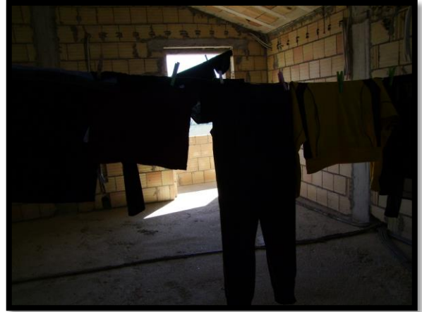
F. 26: INTERNO DELLA SOFFITTA UBICATA AL PIANO 1° SOTTOTETTO IN CONTRADA CAMPOGRANDE, N. 45 TORINO DI SANGRO (CH), P.LLA 4070 SUB. 2 (A/2)
