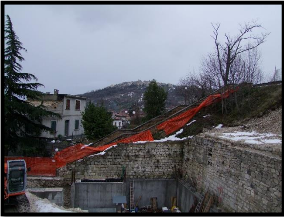
F. 09: VISTA DALL'ABITAZIONE UBIcata AL PIANO 1° IN VIA NAZIONALE, N. 79 – FARA SAN MARTINO (CH), P.LLA 1162 SUB. 3
