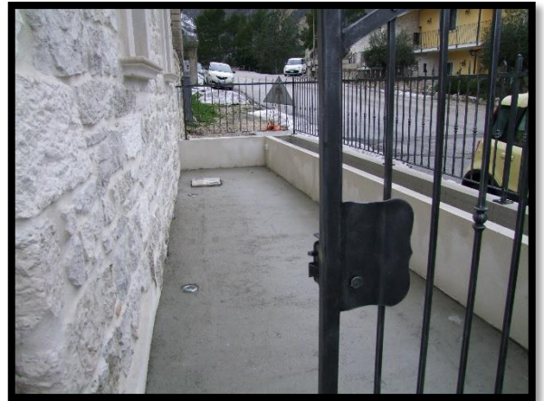
F. 04: AREA ESCLUSIVA PERTINENZIALE UBICATA AL PIANO TERRA IN VIA NAZIONALE, N. 79 – FARA SAN MARTINO (CH), P.LLA 1162 SUB. 3
