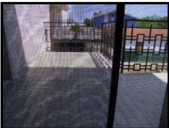
F. 35: BALCONE DELL'APPARTAMENTO UBICATO AL PIANO 1° IN CONTRADA SINAGLIA, N. 90 – PAGLIETA (CH), P.LLA 407 SUB. 3 (A/3)
