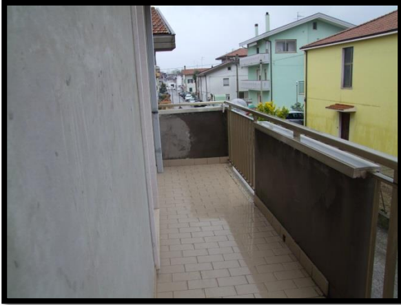
F. 13: BALCONE DELL'APPARTAMENTO POSTO AL PIANO 1°, P.LLA 211 SUB. 12
