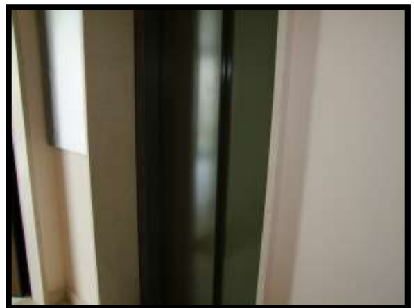
F. 12: ASCENSORE COMUNE UBICATO AL PIANO 5° DA VIA GALILEO GALILEI, N. 9, SCALA "A" E PIANO 3° DA VIA MARCONI – VINCHIATURO (CB), P.LLA 857 SUB. 99 (B.C.N.C.)
