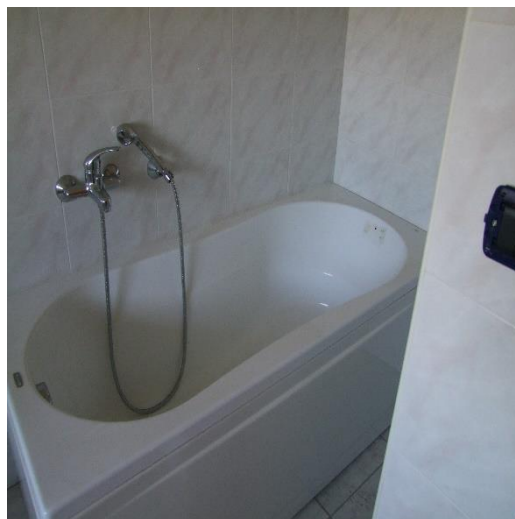
FOTO 38: INTERNO DEL W.C. AL PIANO 1°, P.LLA 4259 SUB. 7 (A/2)
