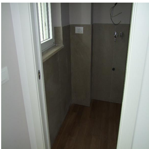
FOTO 41: INTERNO DEL W.C. LETTO "1" AL PIANO 4°, P.LLA 2006 SUB. 99 (A/2)
