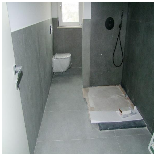
FOTO 50: INTERNO DEL W.C. "2" AL PIANO 4°, P.LLA 2006 SUB. 99 (A/2)
