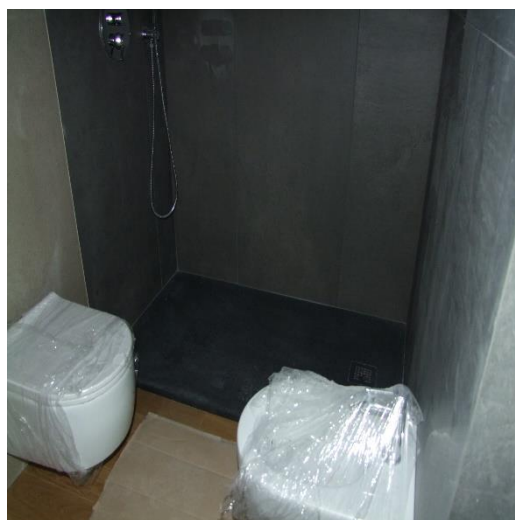
FOTO 40: INTERNO DEL W.C. LETTO "1" AL PIANO 4°, P.LLA 2006 SUB. 99 (A/2)
