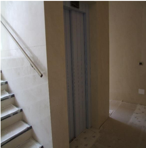
FOTO 13 ASCENSORE COMUNE AL PIANO TERRA P.LLA 2006 SUB. 6 (B.C.N.C.)
