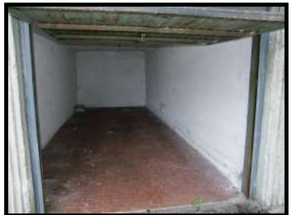
F. 12: INTERNO DEL GARAGE N. "G4" UBICATO AL PIANO TERRA VIA GIACOMO LEOPARDI, N. 53/E, IN LOCALITÀ VAZZIERI – CAMPOBASSO (CB), P.LLA 191 SUB. 4 (C/6)
