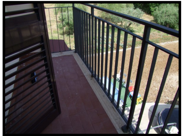
F. 22: BALCONE DELL'ABITAZIONE UBICATA AL PIANO 1° IN VIA TAVERNA, S.N.C. – MONTAQUILA (IS), P.LLA 268 (A7)
