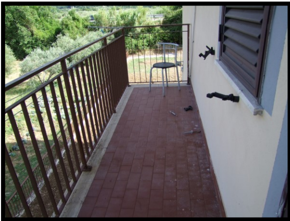
F. 27: BALCONE DELL'ABITAZIONE UBIcata AL PIANO 1° IN VIA TAVERNA, S.N.C. – MONTAQUILA (IS), P.LLA 268 (A7)
