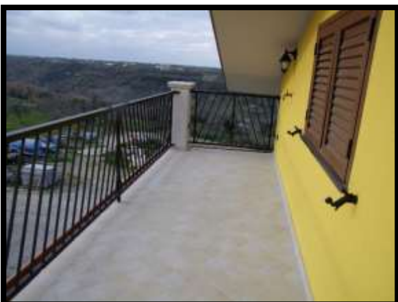
F. 45: TERRAZZO DELLA SOFFITTA UBICATO AL PIANO 1° SOTTOTETTO IN CONTRADA PIANE FAVARO, N. 34 – ROCCA SAN GIOVANNI (CH), P.LLE 4157 SUB. 2 (A/7)
