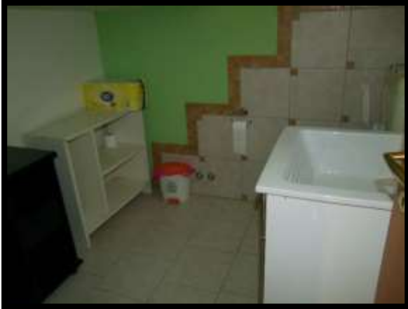
F. 11: INTERNO DEL GARAGE UBICATO AL PIANO SEMIN-TERRATO IN CONTRADA PIANE FAVARO, N. 34 – ROCCA SAN GIOVANNI (CH), P.LLE 4157 SUB. 2 (A/7)
