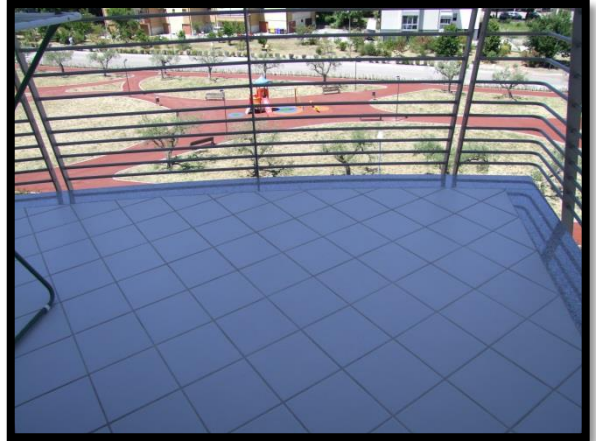
F. 20: BALCONE DELL'APPARTAMENTO INTERNO "30" UBICATO AL PIANO 4° IN VIA GIUSEPPE SPATARO, N. 4/C, QUARTIERE SANTA RITA – LANCIANO (CH), P.LLA 4478 SUB. 38 (A/2)
